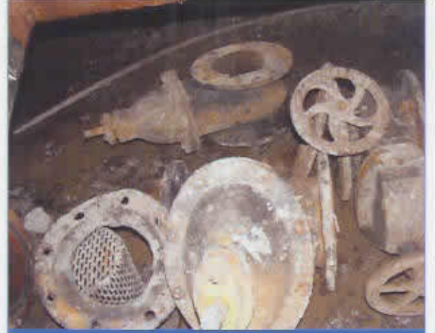
İçmesuyu Vanalarının Değiştirilmeden Önceki Durumu
