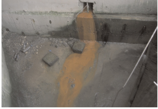
Şeker Pınar Bölgesi Yağmur Suyu Kanalına Yapılan Kacak Deşarjlar
