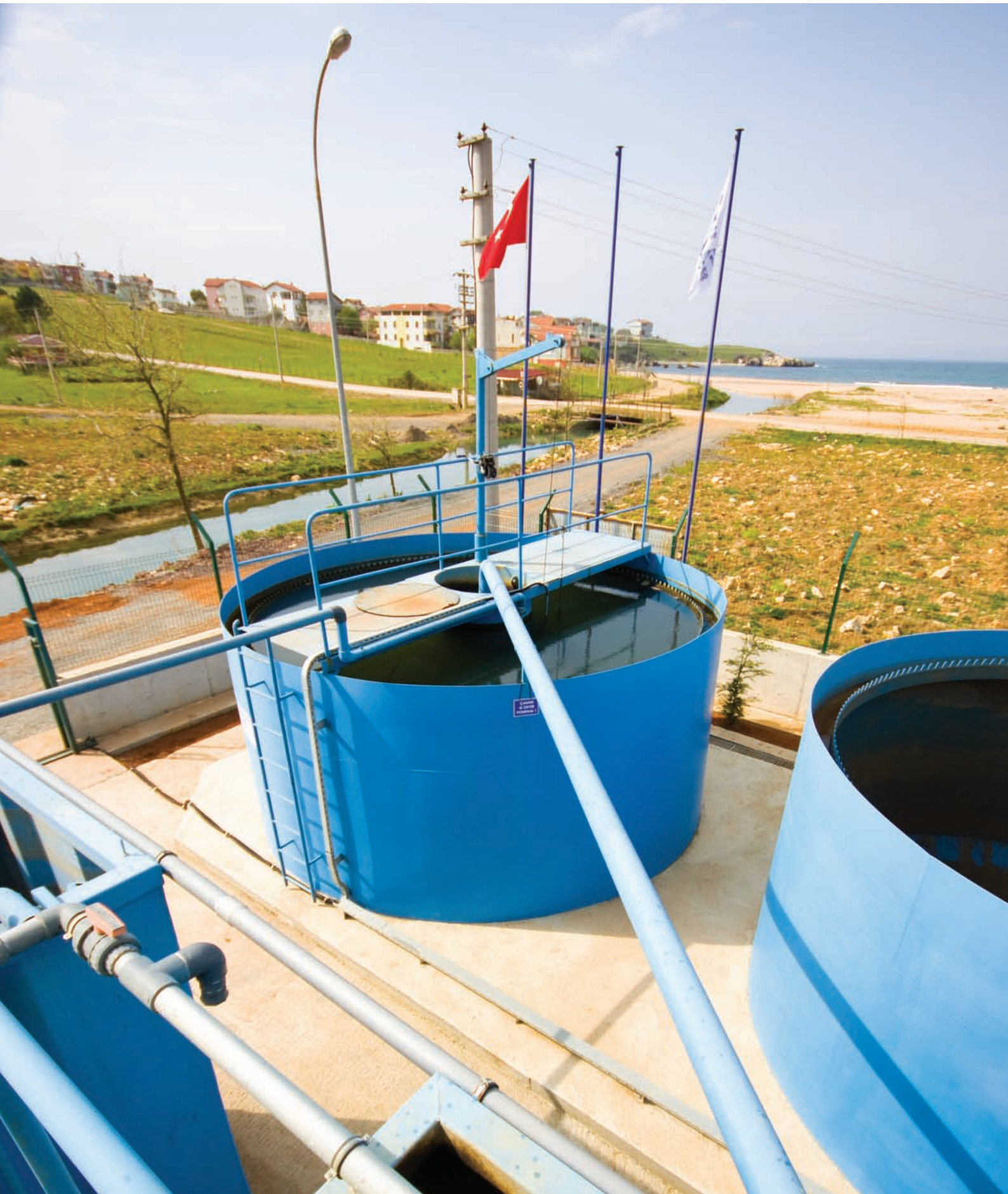
Bağıranlı Modüler Atık Su Arıtma Tesisi
