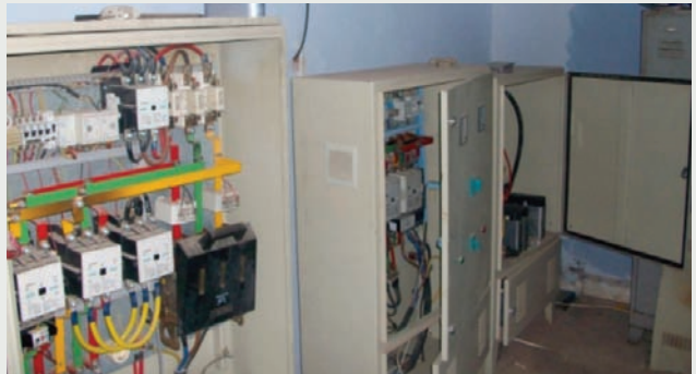
Yeni imalatı yapılan elektrik pano örneği
