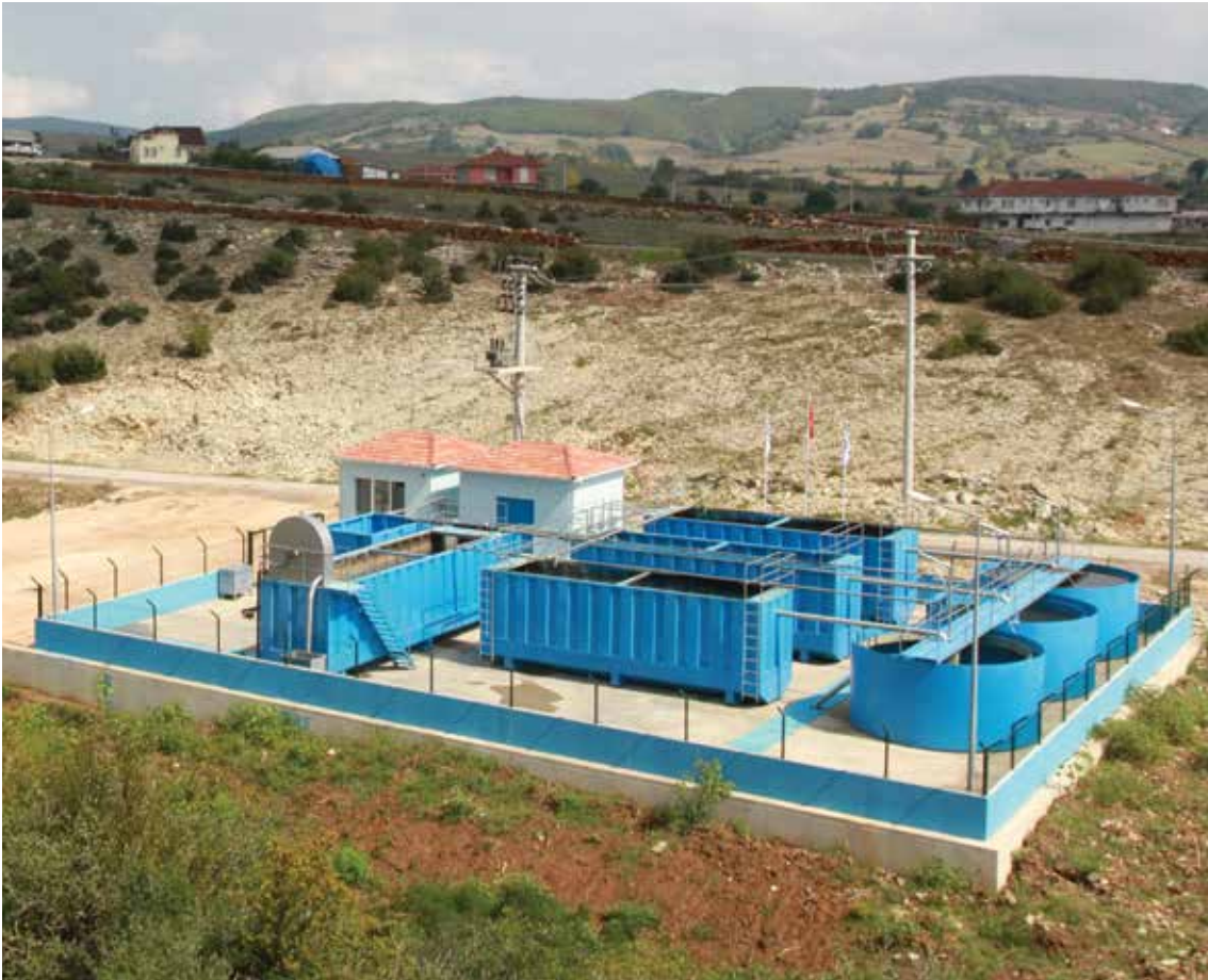
Derince Çavuşlu Modüler Atık Su Arıtma Tesisi
